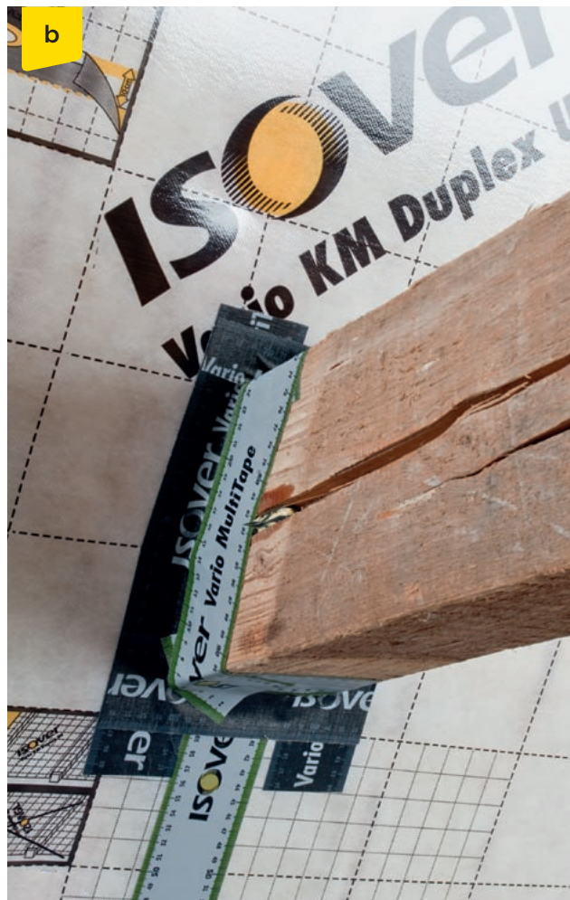
b) u popraskaných trámů ve staré stavbě
